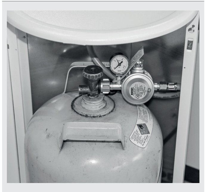
Abb.3: Installation der Gasflasche
